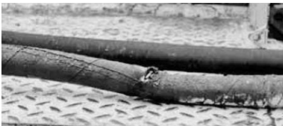
Imagen 1. Manguera que estalló.
